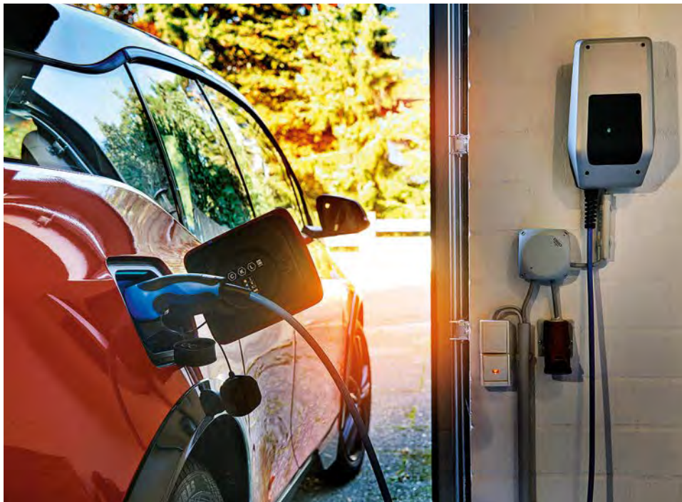
Laden geht auch mit der roten Industriesteckdose. Die Wallbox ist komfortabler.
